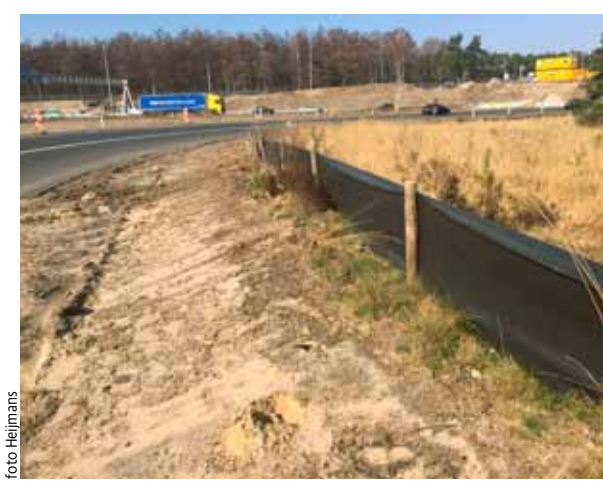
Frequente inspectie en herstel van het scherm is noodzakelijk om een permanente wering van reptielen uit het werkgebied te garanderen.
