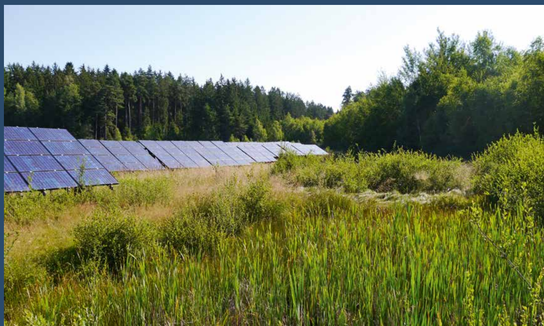
Foto 4. Zonnepark Hemau (bij Regensburg, Duitsland). In dit natuurinclusieve zonneveld zijn de afstanden tussen de rijen panelen relatief groot en zijn er plekken vrijgehouden om de ecologische waarden te behouden en te versterken.
